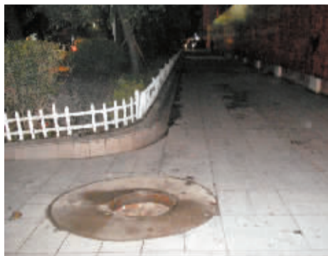
这个人行道上的盖板消失了,成为一个安全陷阱。苏霓摄
